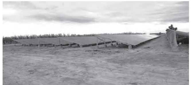
ヨルダンのマフラク地区で運営する太陽光発電所
